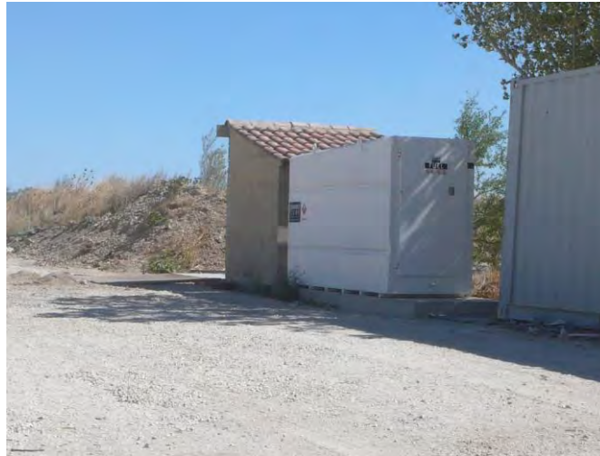
Stockage des hydrocarbures (4125 litres) en double paroi avec capacité de rétention équivalente à 110 % du volume stocké
